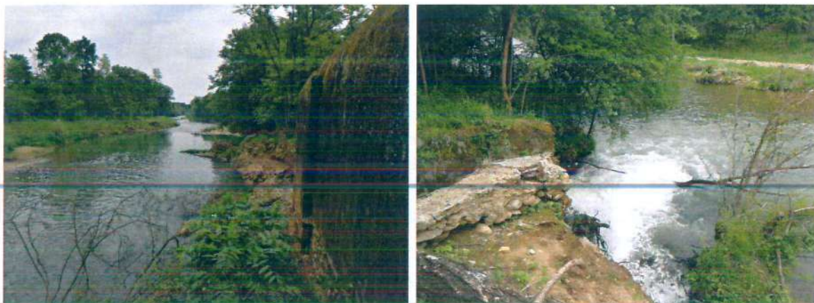
Figura 6 – Erosione spondale in destra idrografica con asportazione di parte della pista ciclabile di collegamento con l'ingresso del Parco della Mandria, e danneggiamento del canale di restituzione al Ceronda
