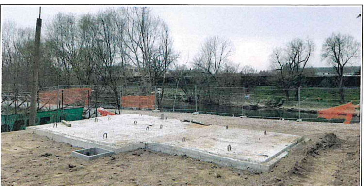
Foto20 – Camere di pompaggio della nuova rete fognaria realizzata tra l'area dei Ronchi Verdi e l'A.S.D. Master Club Fioccardo
