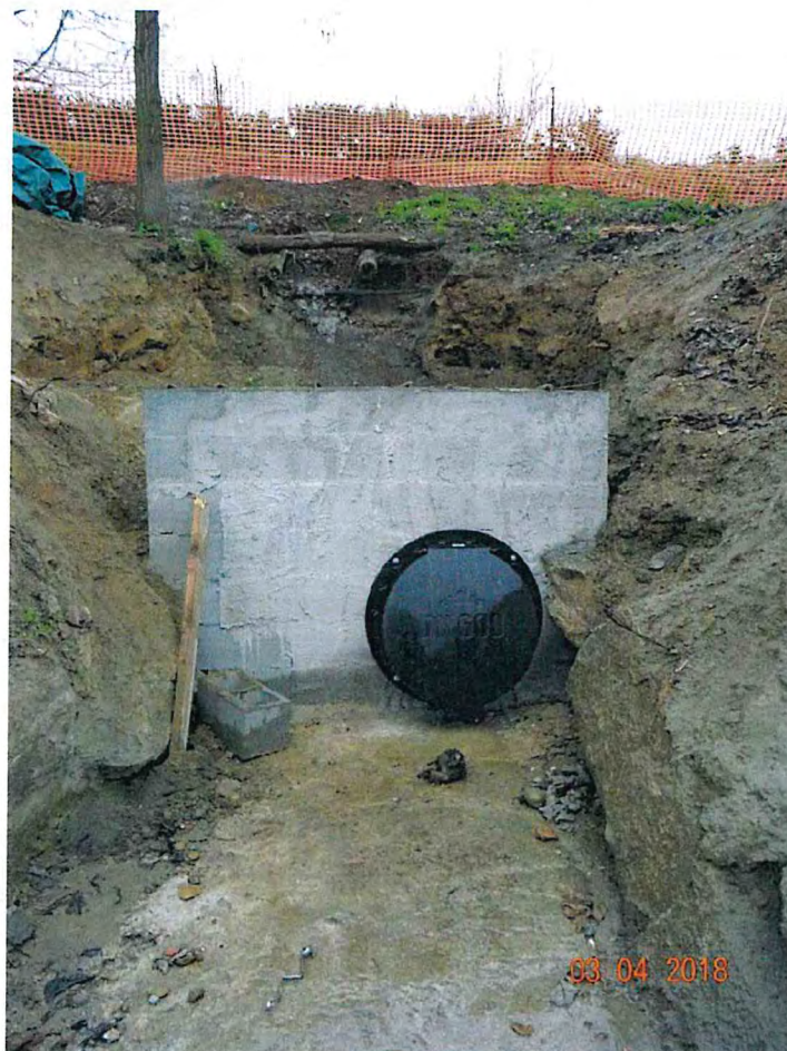
Figura 2-11 – Valvola di controllo inserita allo sbocco della condotta che recapita in Po le acque bianche provenienti dal comprensorio dei Ronchiverdi s.p.a. (foto 2343-DSC01883)
