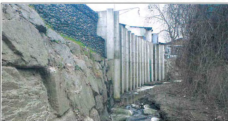
Foto 5 – Stazione idro-pluviometrica del Rio Sappone ed elementi di difesa spondale lato A.S.D. Master Club Fioccardo
