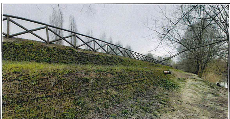
Foto18 – Tipologia fascia spondale tra il Rio Sappone ed i Ronchi Verdi con le vecchie tubazioni di scarico delle acque meteoriche
