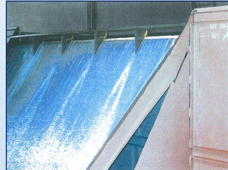
Comportamento idraulico dello sfioratore di superficie in condizioni di portata smaltita pari alla portata massima di progetto.
