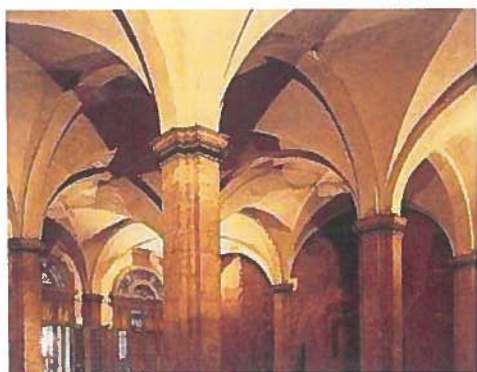
Fotografia della Sala del Voltone con la copertura del cortile medioevale realizzata nel 1638-40
