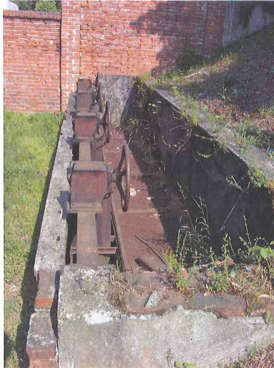
Foto 3 – Opere di regolazione della portata sul Canale Pellerina a valle dell’opera di presa.
